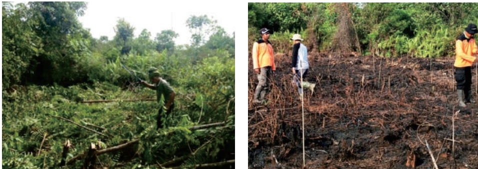
Gambar 13.5. Pembukaan dan pemasangan ajir di lahan gambut KPHP Lakitan BC (Foto: KPHP Lakitan BC)
